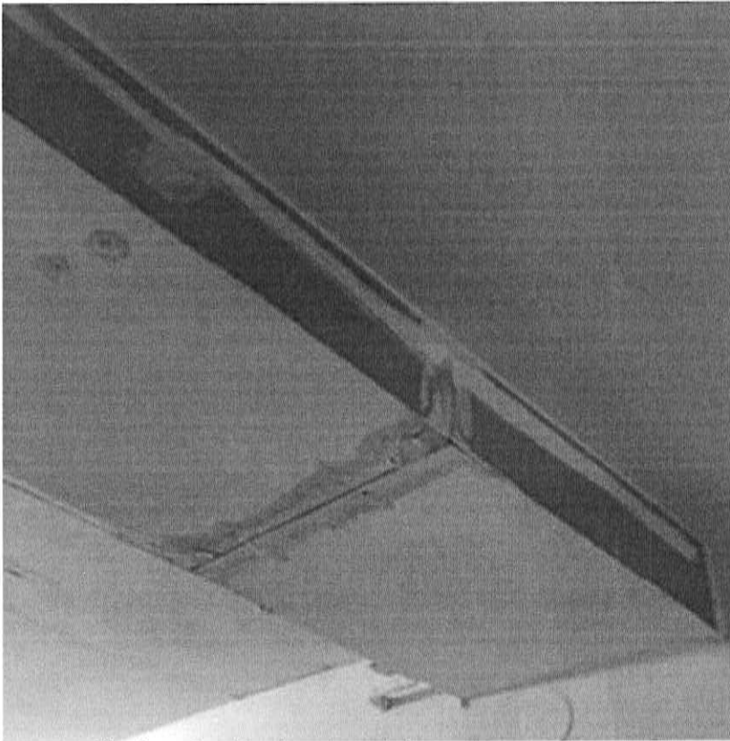
Wasserflecken im Deckenbereich
