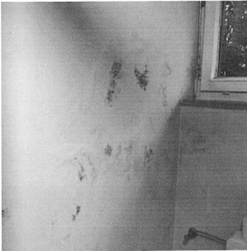
Verschimmelte Wände WC Bereich
