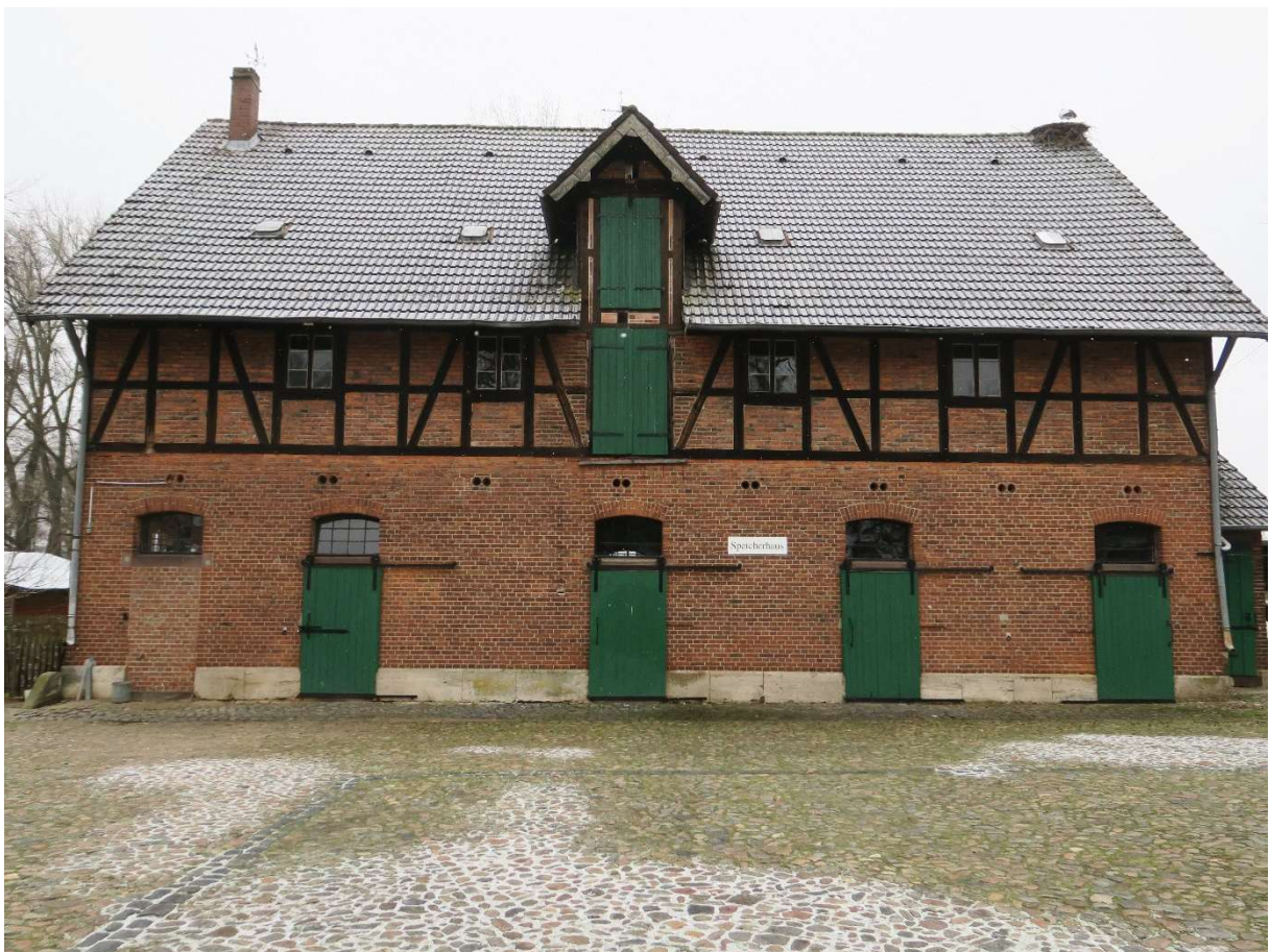
Ansicht Speicherhaus, Dachrinne ist an allen Stößen und neben der Gaube defekt
