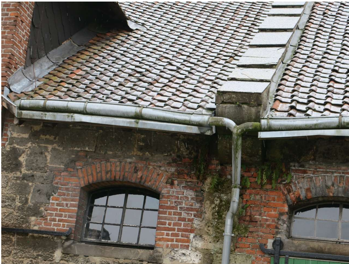
Aufgesetzte Dachrinne mit Nässeproblemen im Dach und der Wand
