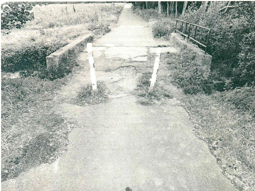
Bild 2: Geländer fehlt, Asphalt ist katastrophal
