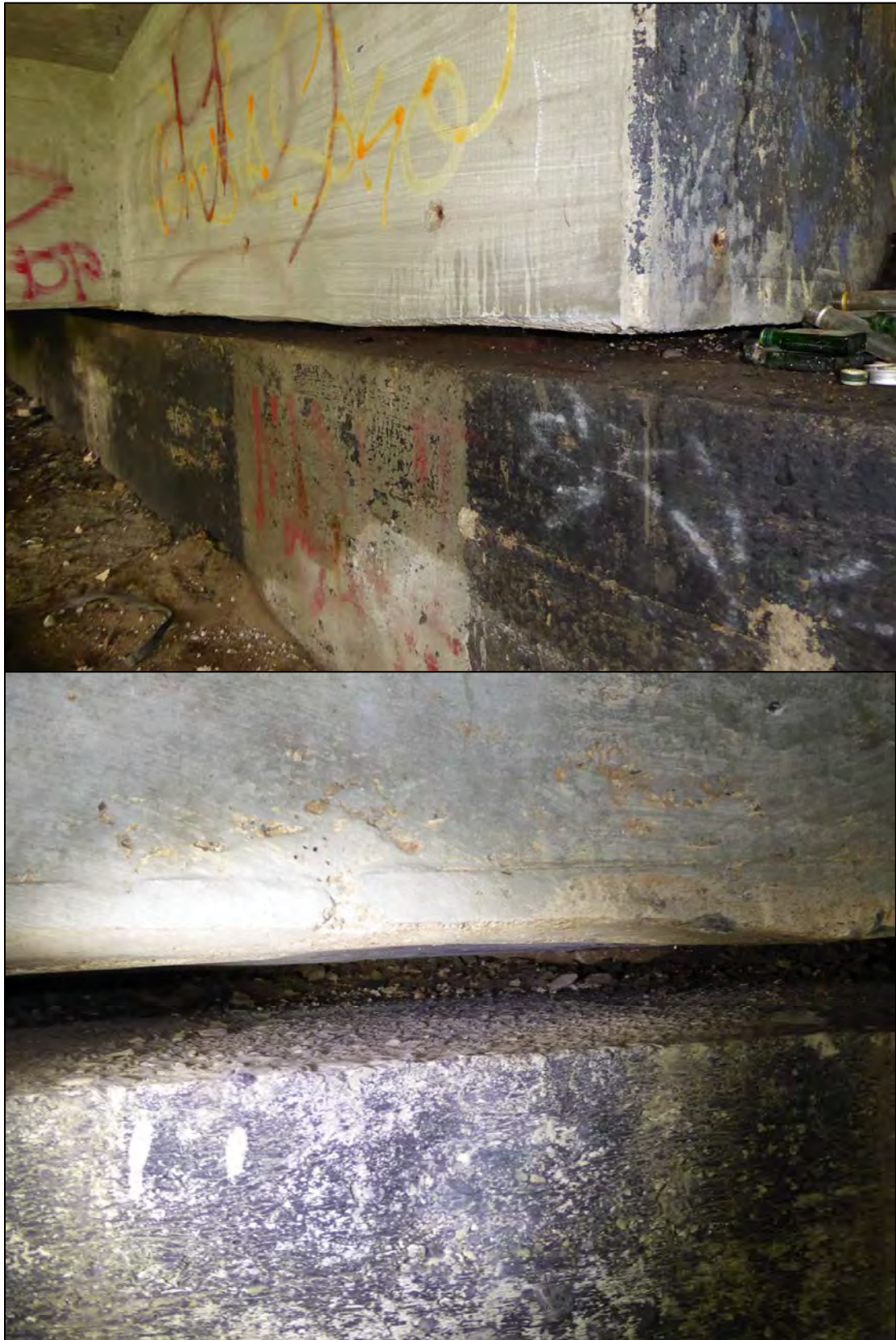
Abb. 2-1: Spalten unter der Straßenbrücke.
